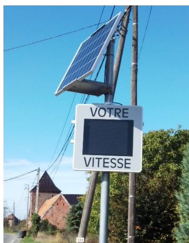
Radars pédagogiques rue Angèle Lecat rue du Grand Chemin
